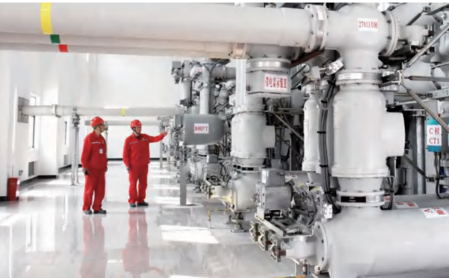
220kV 变电站 GIS 设备巡检
