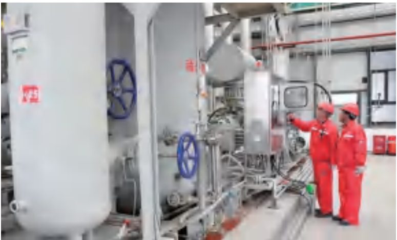
压缩机房巡检
