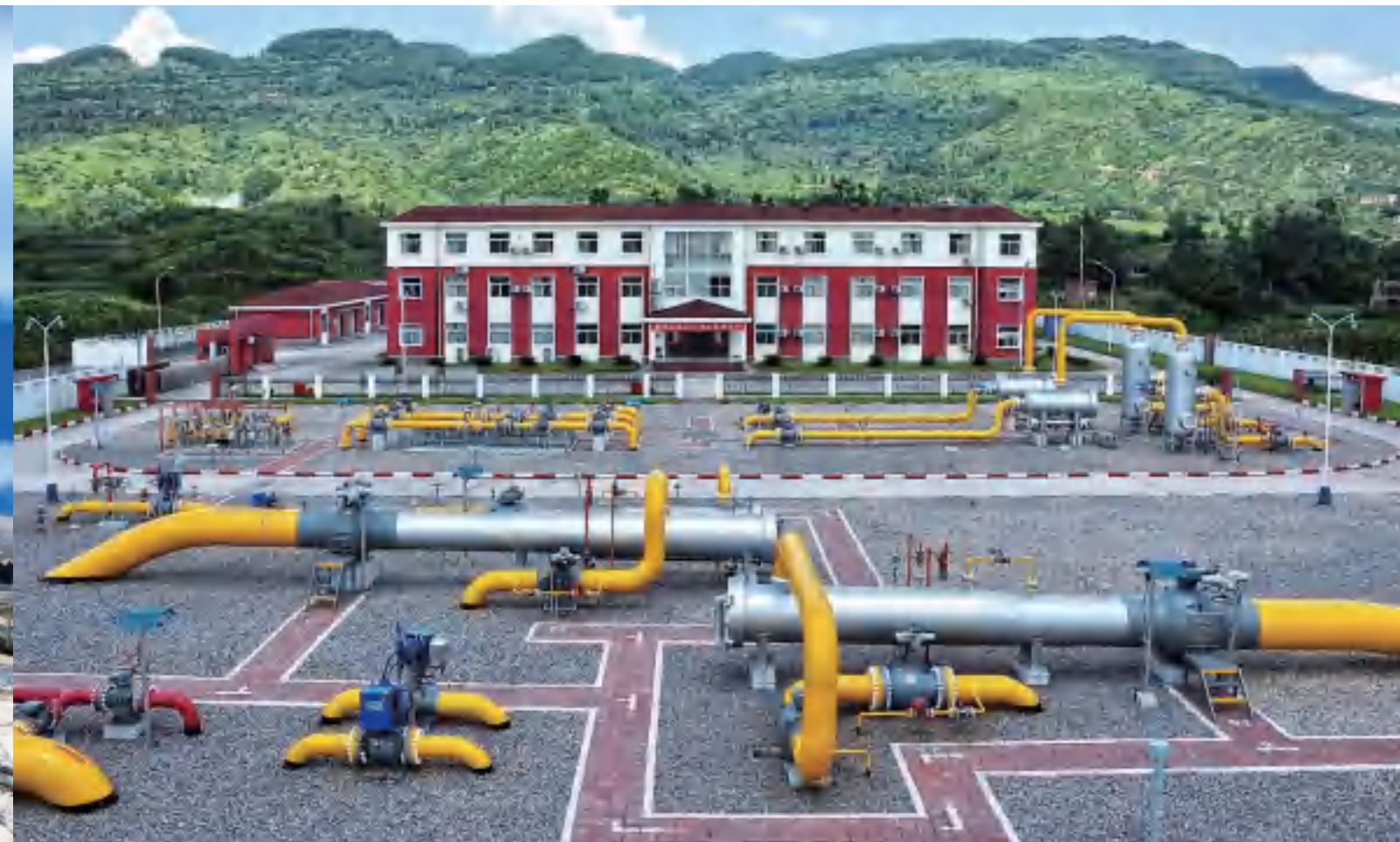
输气场站运维
