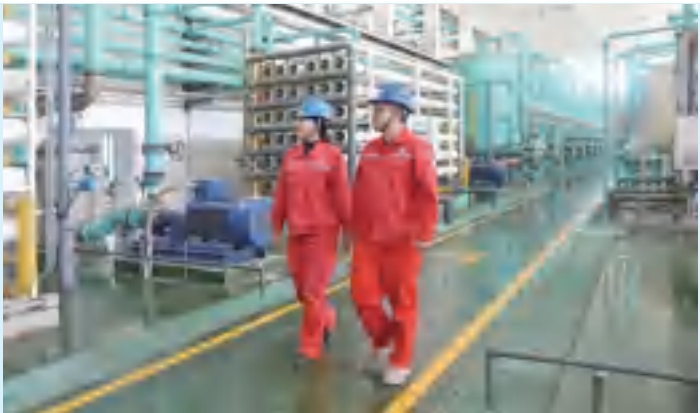
热力设备巡检
