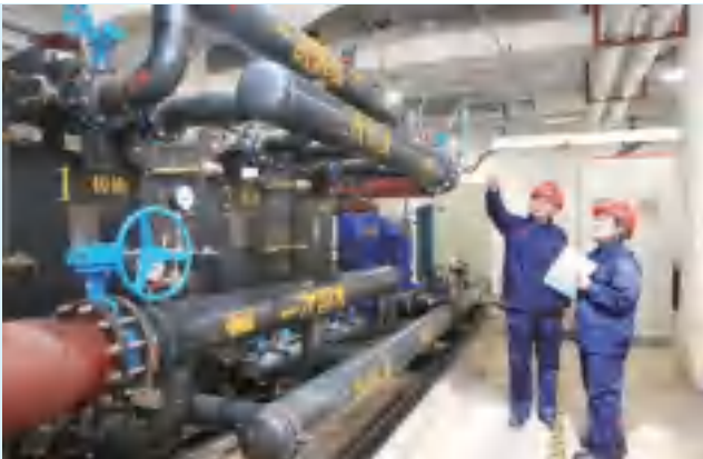
供热设备维保
