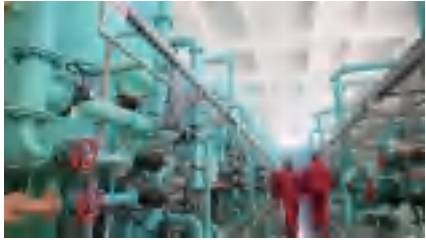
脱盐水装置制水运维
